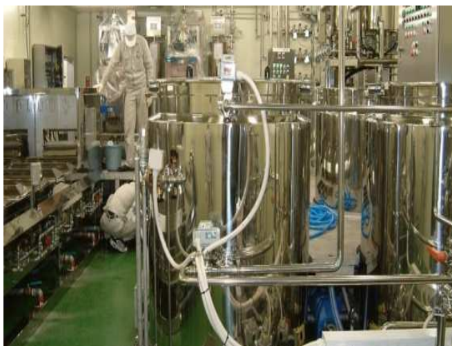
だし製造設備
