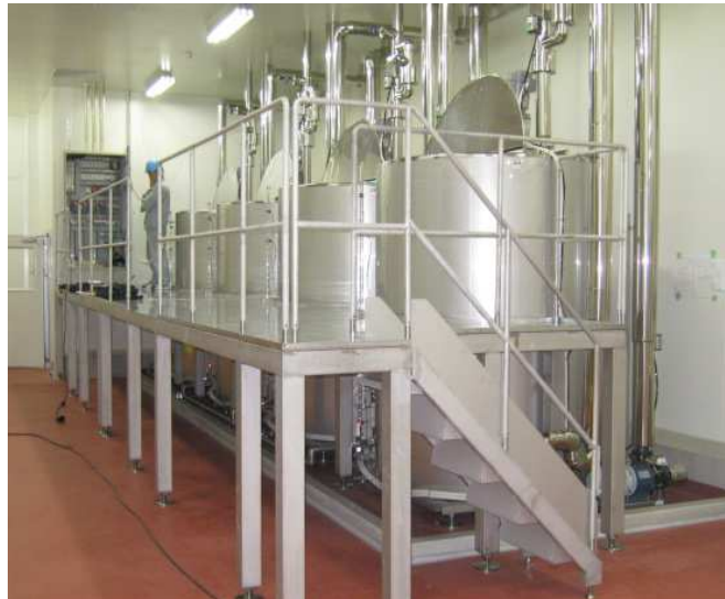
製麺用練水製造設備
